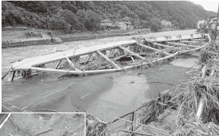
河川の洪水により破壊された新天瀬橋
