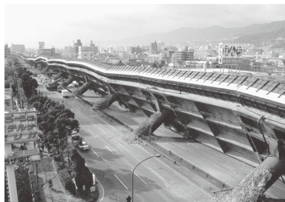
橋脚が倒壊した阪神高速道（阪神淡路大震災）
